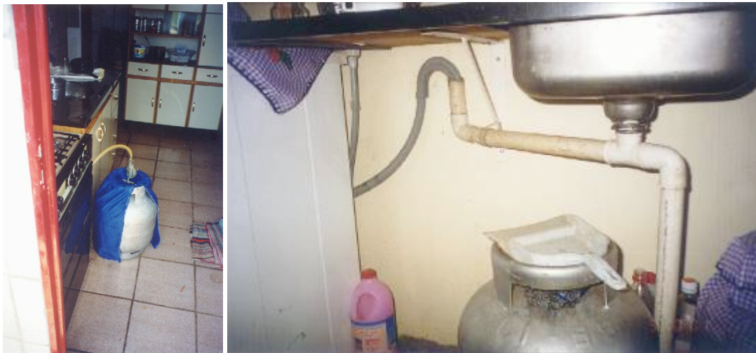
Figura 1 – Dificuldade de disposição de equipamentos no espaço da cozinha. Fonte: Canto (2002)
