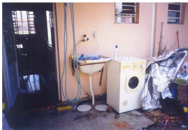
Figura 3 - Derivação na torneira do tanque para mangueira de abastecimento da máquina de lavar. O sifão (“cachimbo”) pendurado no suporte metálico do tanque. Ao lado do equipamento, lona plástica para proteção da máquina. Fonte: Canto (2002).
