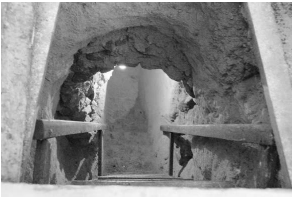
Figura 2 - Detalhe do túnel mostrando a escada em madeira. Deterioração por umidade e ataque de insetos.
