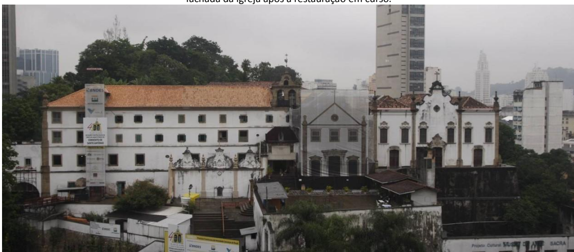
Figura 11: Covento de Santo Antônio em processo de restauro –colocação de uma espécie de banner que informa a feição da fachada da igreja após a restauração em curso.
