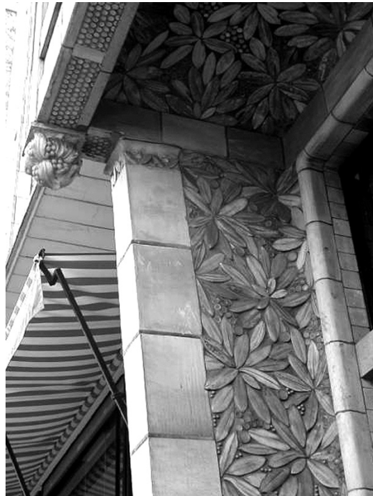
Fig. 04 - Auguste Perret: 25 bis da Rua Franklin, Paris, 1903- 1905. Vista inferior do balanço da laje. (Disponível em < https://files1.structurae.de/files/photos/64/paris25frank04.jpg >)
